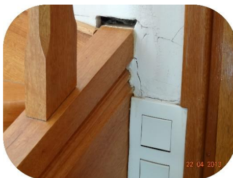
Fissuration doublage intérieur menuiserie cage d'escaliers
