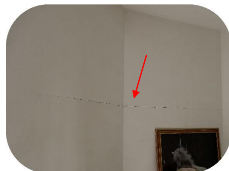
Fissuration murale doublage intérieur
